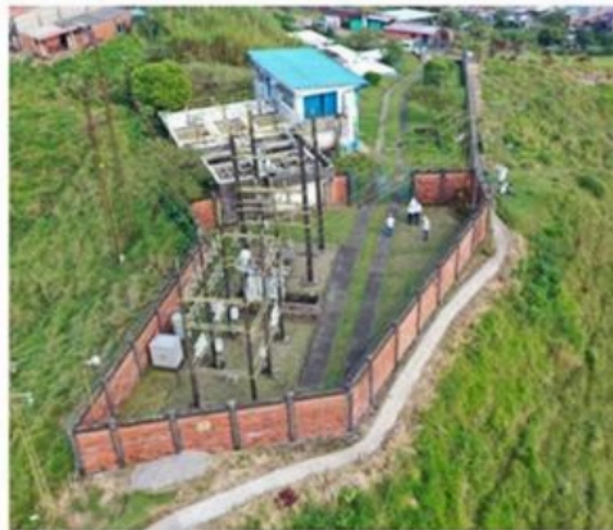
*Vista aérea Subestación Samaná (Samaná – Caldas)
