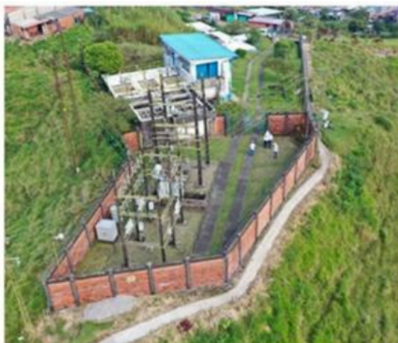
*Vista aérea Subestación Samaná (Samaná – Caldas)
