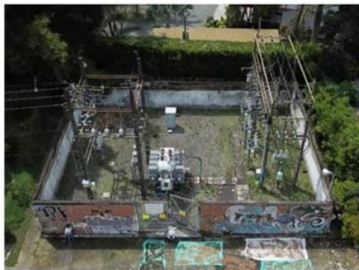
*Vista aérea Subestación Campestre (Dosquebradas – Risaralda)
