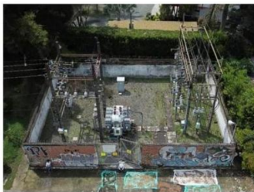
*Vista aérea Subestación Campestre (Dosquebradas – Risaralda)
