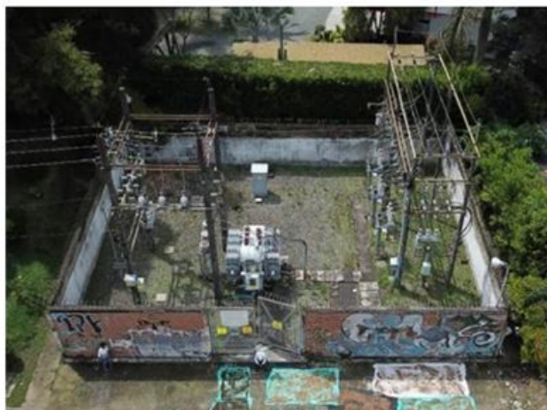
*Vista aérea Subestación Campestre (Dosquebradas – Risaralda)
