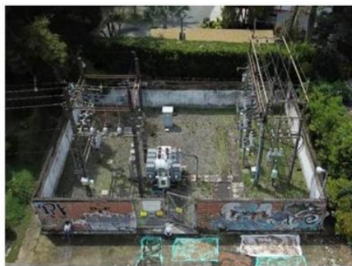
*Vista aérea Subestación Campestre (Dosquebradas – Risaralda)
