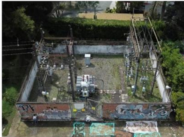
*Vista aérea Subestación Campestre (Dosquebradas – Risaralda)
