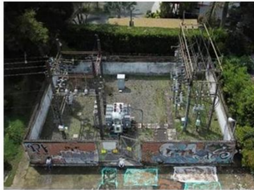
*Vista aérea Subestación Campestre (Dosquebradas – Risaralda)
