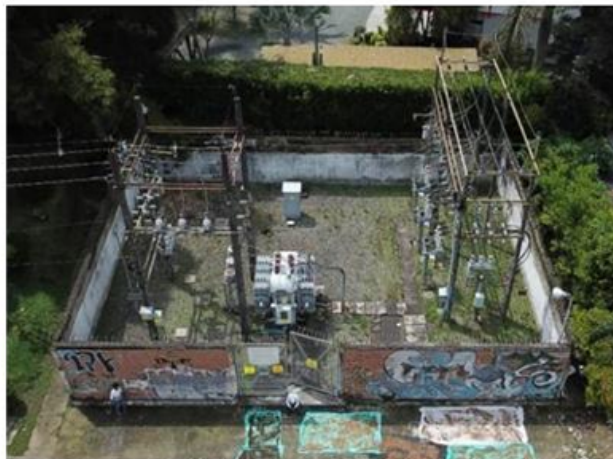
*Vista aérea Subestación Campestre (Dosquebradas – Risaralda)
