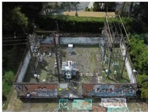
*Vista aérea Subestación Campestre (Dosquebradas – Risaralda)
