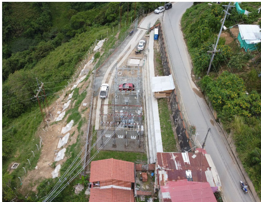
*Vista aérea Subestación El Dorado (Marmato – Caldas)
