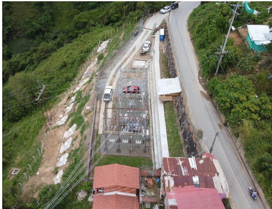
*Vista aérea Subestación El Dorado (Marmato – Caldas)
