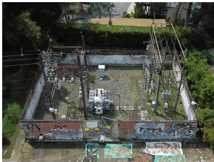
*Vista aérea Subestación Campestre (Dosquebradas – Risaralda)
