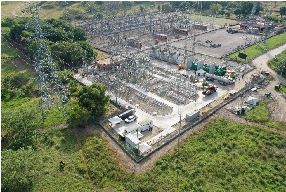
*Vista aérea Subestación Purnio (La Dorada – Caldas)
