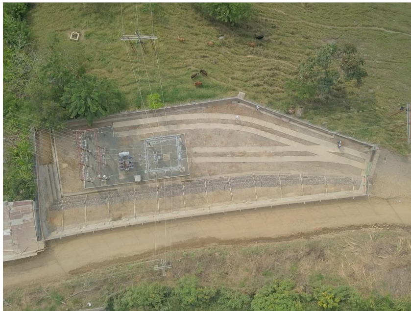
*Vista aérea Subestación El Dorado (Marmato – Caldas)
