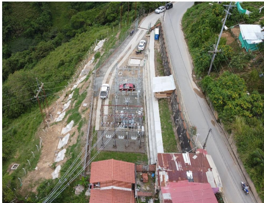
*Vista aérea Subestación El Dorado (Marmato – Caldas)
