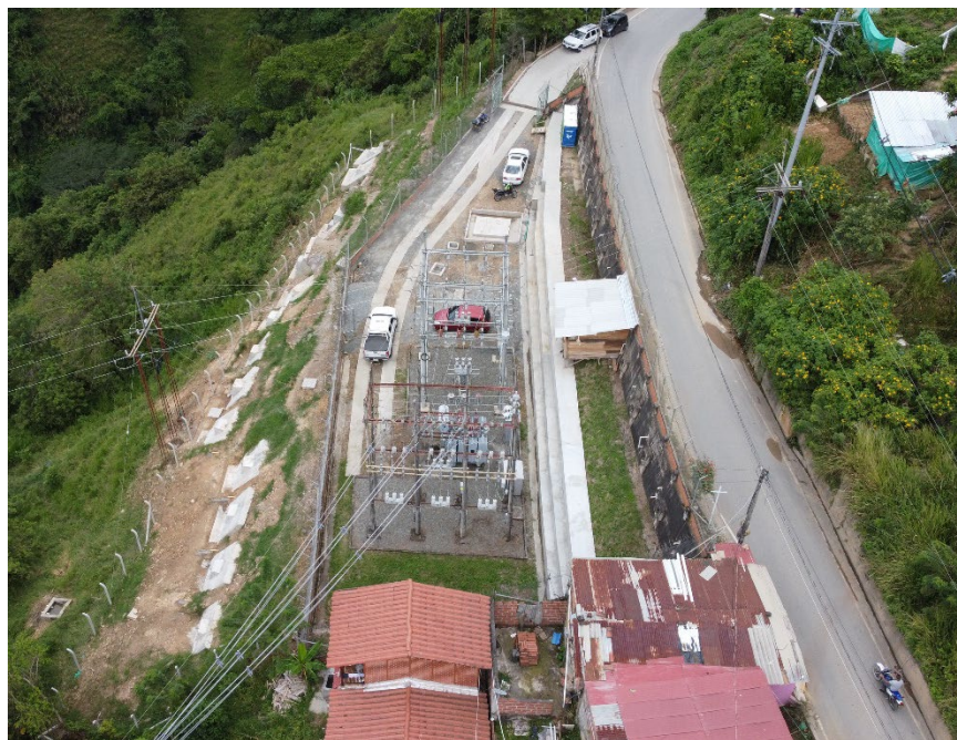
*Vista aérea Subestación El Dorado (Marmato – Caldas)
