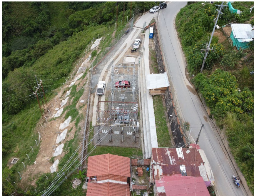
*Vista aérea Subestación El Dorado (Marmato – Caldas)
