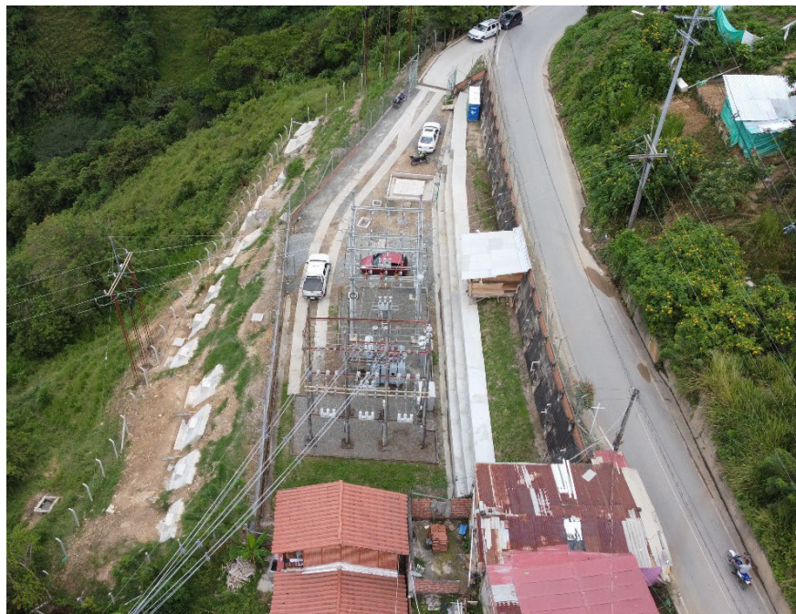
*Vista aérea Subestación El Dorado (Marmato – Caldas)
