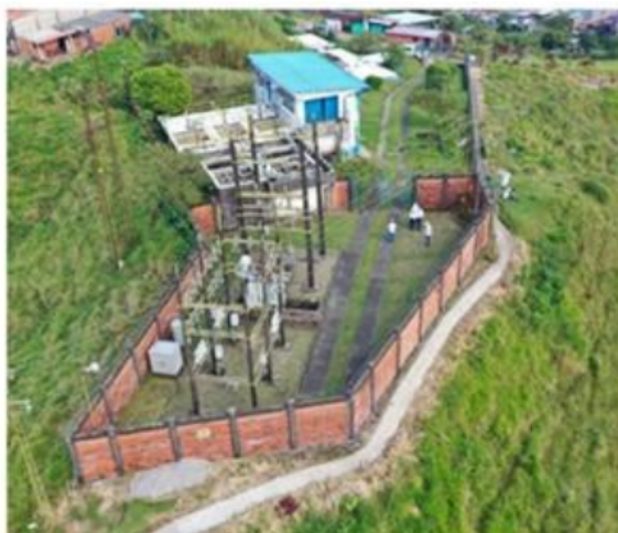
*Vista aérea Subestación Samaná (Samaná – Caldas)
