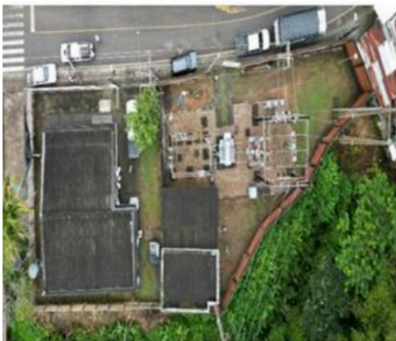
Vista aérea Subestación Norcasia (Norcasia – Caldas)
