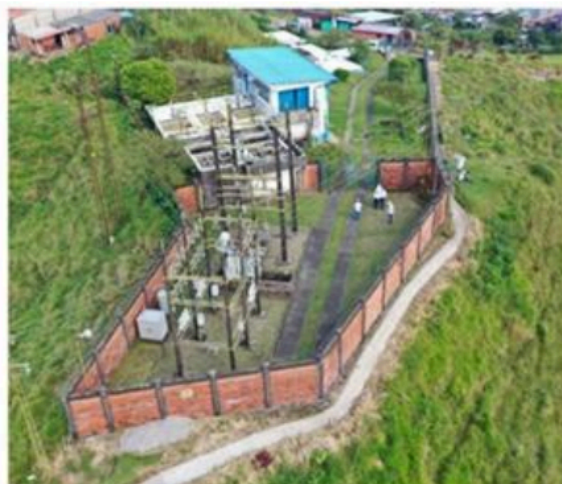
*Vista aérea Subestación Samaná (Samaná – Caldas)
