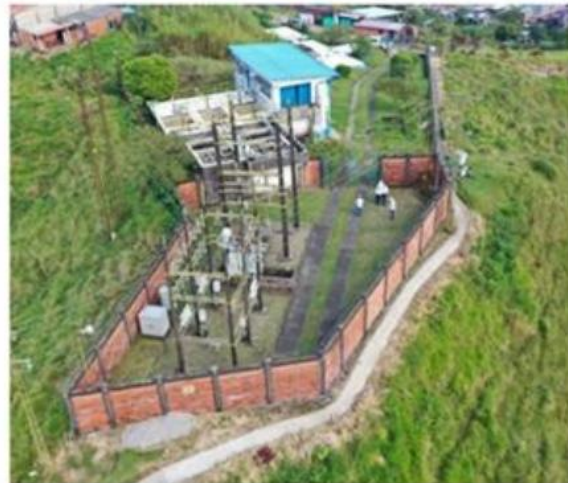
*Vista aérea Subestación Samaná (Samaná – Caldas)
