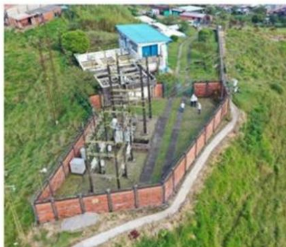
*Vista aérea Subestación Samaná (Samaná – Caldas)
