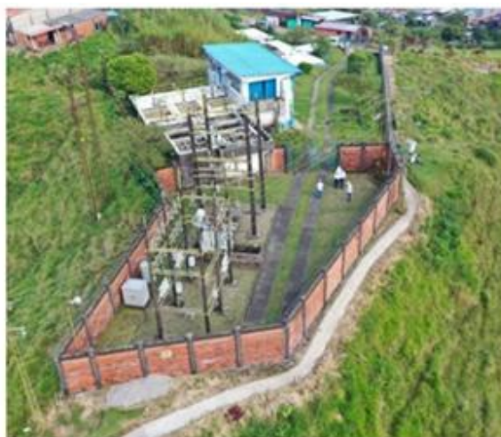
*Vista aérea Subestación Samaná (Samaná – Caldas)
