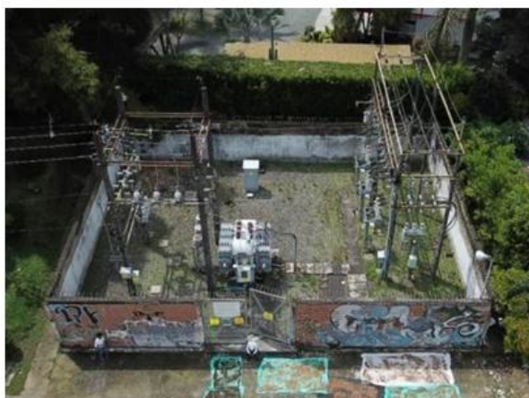
*Vista aérea Subestación Campestre (Dosquebradas – Risaralda)
