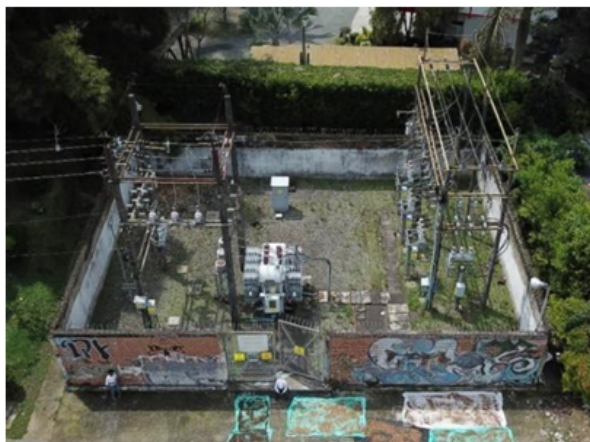
*Vista aérea Subestación Campestre (Dosquebradas – Risaralda)
