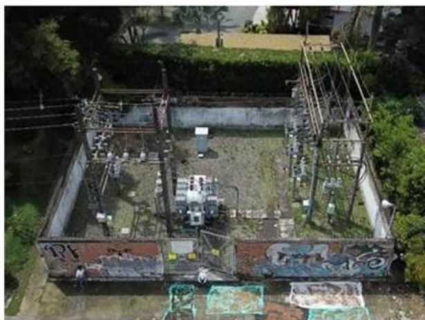
*Vista aérea Subestación Campestre (Dosquebradas – Risaralda)
