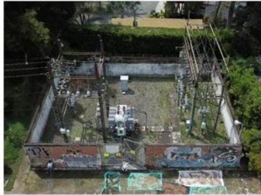
*Vista aérea Subestación Campestre (Dosquebradas – Risaralda)
