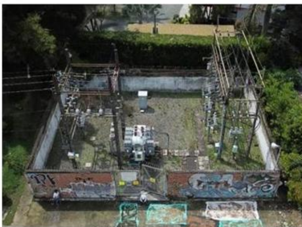
*Vista aérea Subestación Campestre (Dosquebradas – Risaralda)
