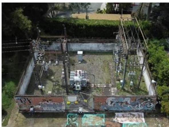
*Vista aérea Subestación Campestre (Dosquebradas – Risaralda)
