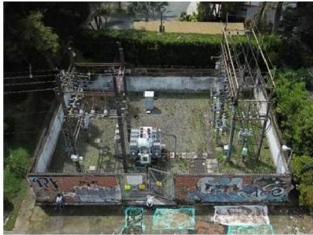
*Vista aérea Subestación Campestre (Dosquebradas – Risaralda)
