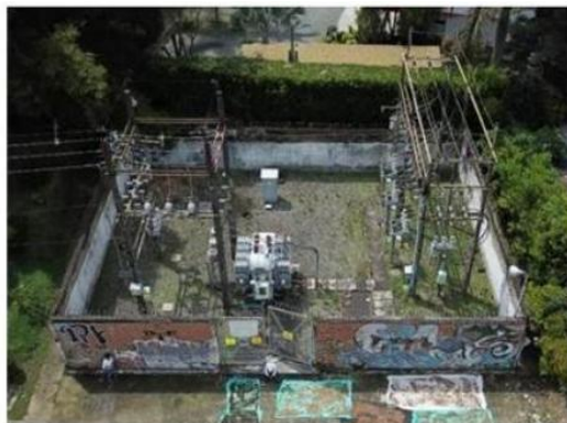
*Vista aérea Subestación Campestre (Dosquebradas – Risaralda)
