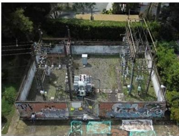
*Vista aérea Subestación Campestre (Dosquebradas – Risaralda)
