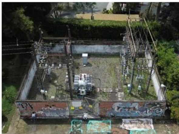
*Vista aérea Subestación Campestre (Dosquebradas – Risaralda)
