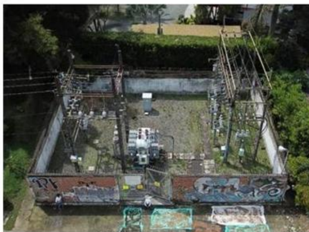
*Vista aérea Subestación Campestre (Dosquebradas – Risaralda)
