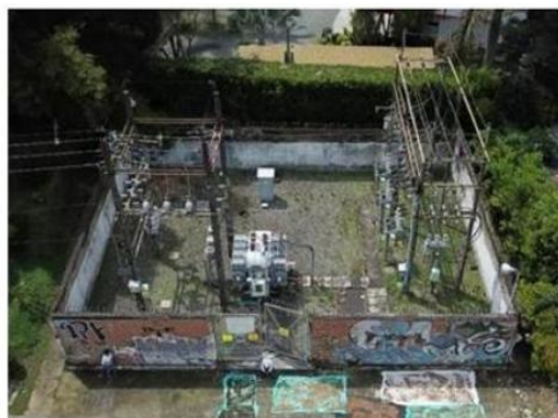
*Vista aérea Subestación Campestre (Dosquebradas – Risaralda)
