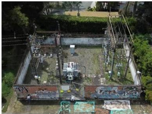
*Vista aérea Subestación Campestre (Dosquebradas – Risaralda)
