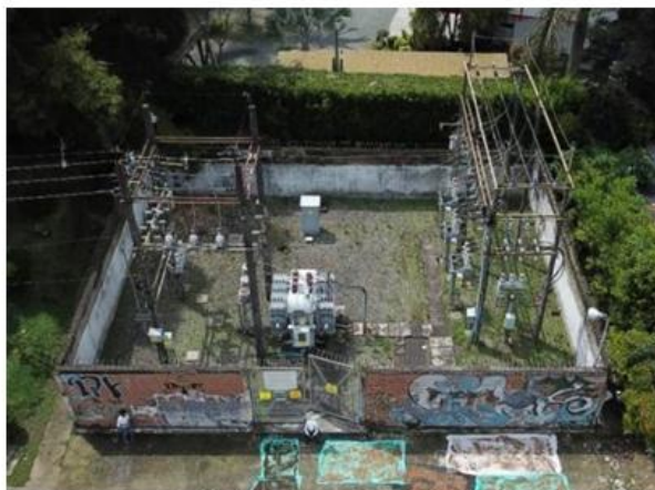
*Vista aérea Subestación Campestre (Dosquebradas – Risaralda)
