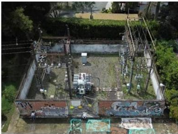
*Vista aérea Subestación Campestre (Dosquebradas – Risaralda)
