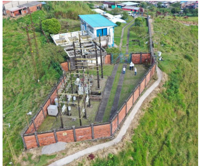
*Vista aérea Subestación Samaná (Samaná – Caldas)
