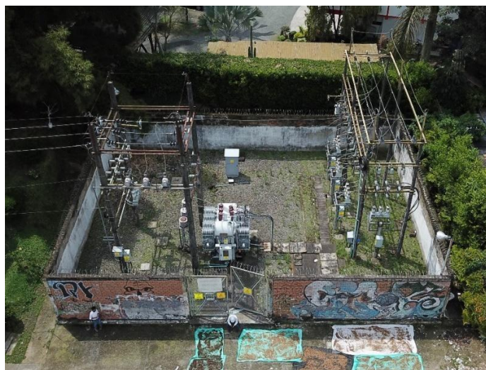
*Vista aérea Subestación Campestre (Dosquebradas – Risaralda)
