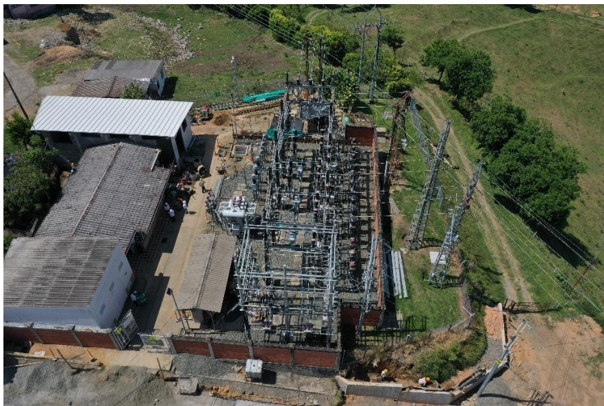
*Vista aérea Subestación Anserma (Anserma – Caldas)
