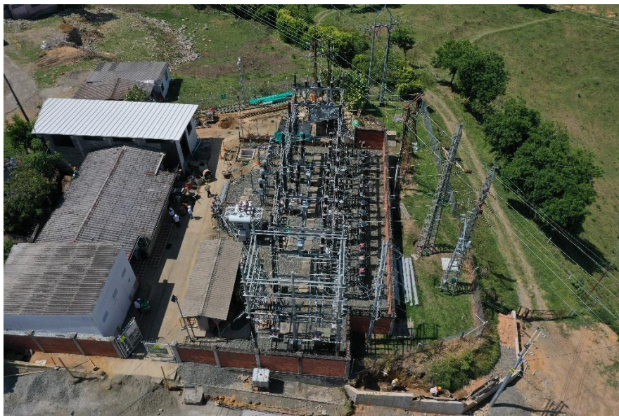
*Vista aérea Subestación Anserma (Anserma – Caldas)
