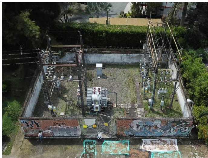
*Vista aérea Subestación Campestre (Dosquebradas – Risaralda)
