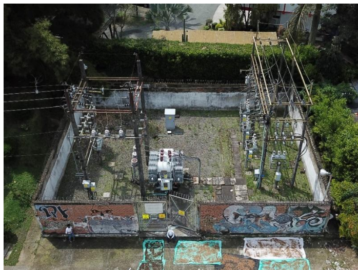
*Vista aérea Subestación Campestre (Dosquebradas – Risaralda)
