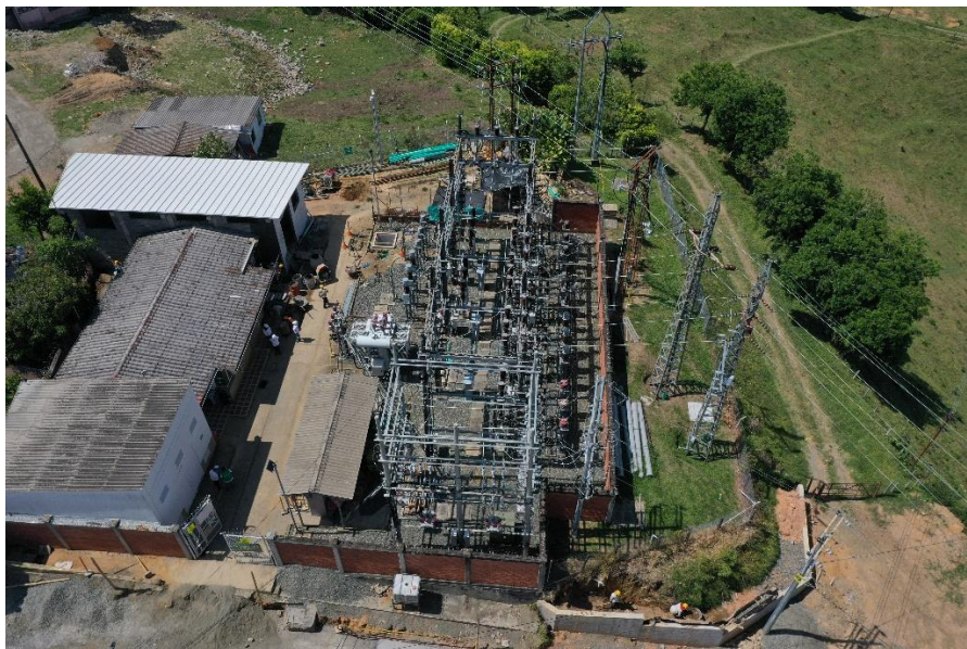
*Vista aérea Subestación Anserma (Anserma – Caldas)
