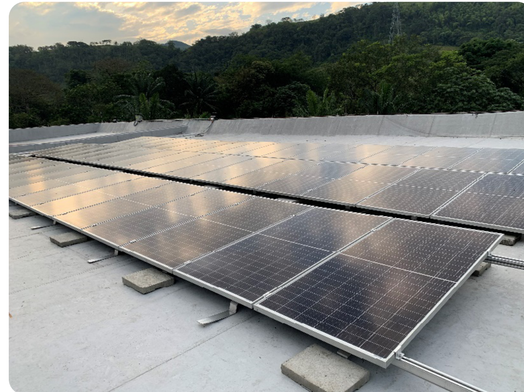
Paneles solares instalados
