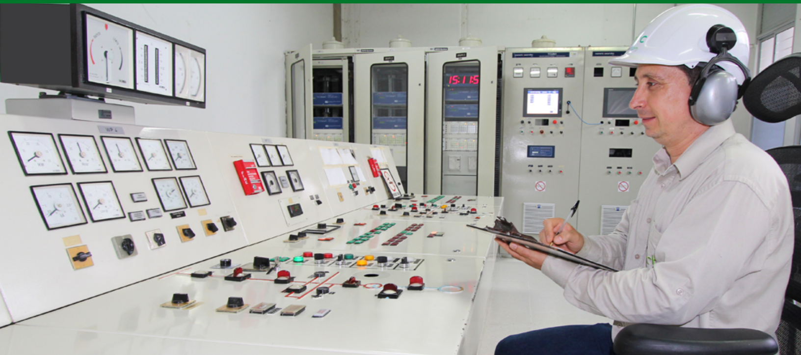
Trabajador planta de generación San Francisco
