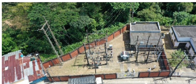
*Vista aérea Subestación Norcasia
