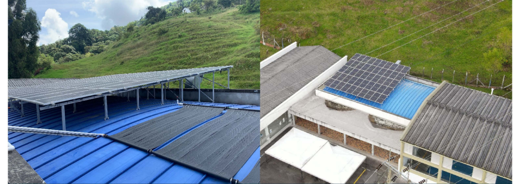
Restaurante CHEC: Segunda instalación solar fotovoltaica dentro de las instalaciones de la Estación Uribe para abastecer el 50% de la demanda de este edificio, a partir de 50 paneles instalados, con una capacidad de 20kWp.
