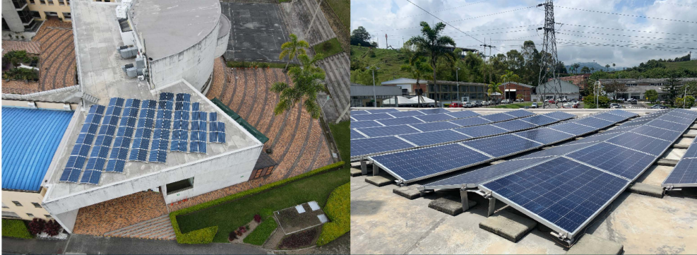
Edificio Inteligente CHEC: Pusimos en funcionamiento un sistema de paneles solares que abastece de energía al Edificio 3 de Estación Uribe, donde se encuentran el auditorio, las salas de capacitación, hall principal, cafetín y baños, gracias a su capacidad instalada de 25,92 kWp.
