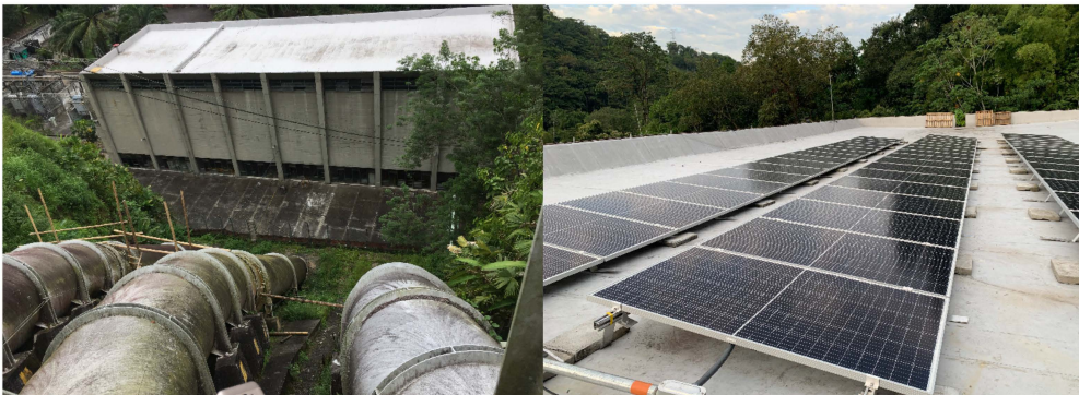
Planta San Francisco: Instalación solar en nuestra planta de generación San Francisco, con una capacidad instalada de 20,4 kWp.
